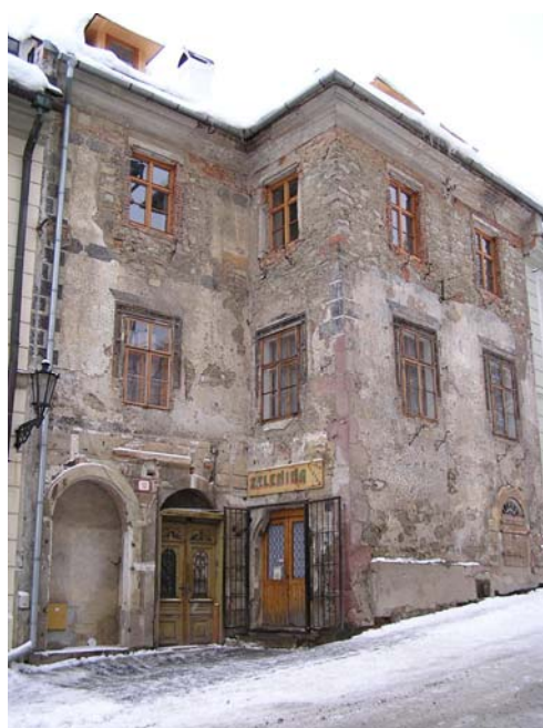
Fasáda po odstránení klasicistickej náležov v kombinácii s barokovou výzdobou
